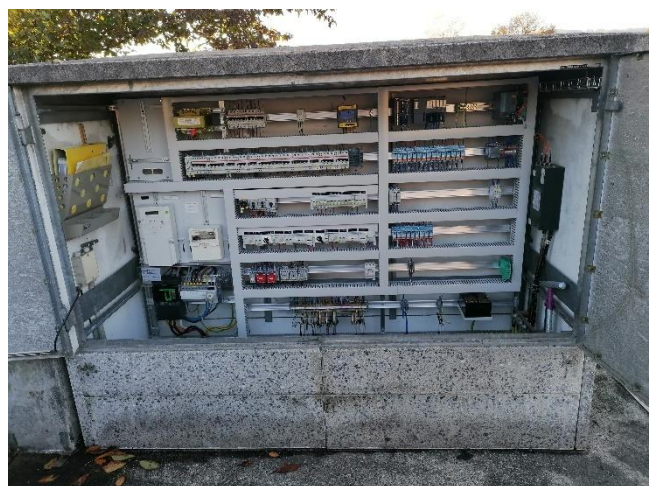
Pumpwerk Übrig, Ersatz EMSRL
