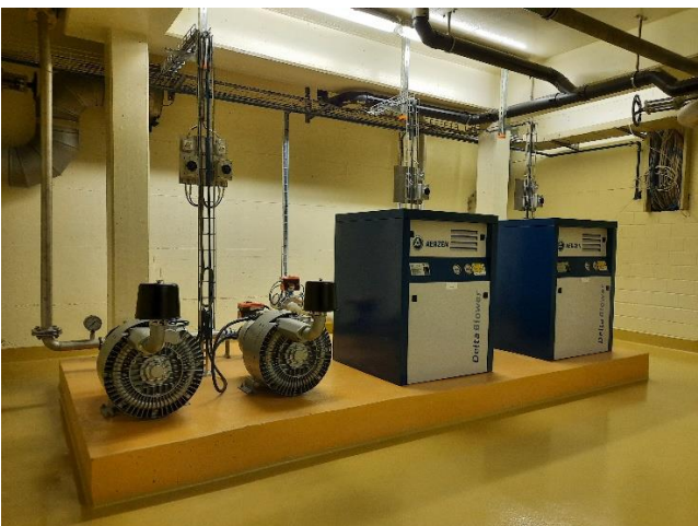
Neue Verdichter (Mammutpumpe), neue Gebläse (Belüftung)
