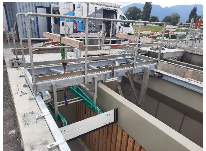
Pro Sandfang ein neuer Seilzugräumer
