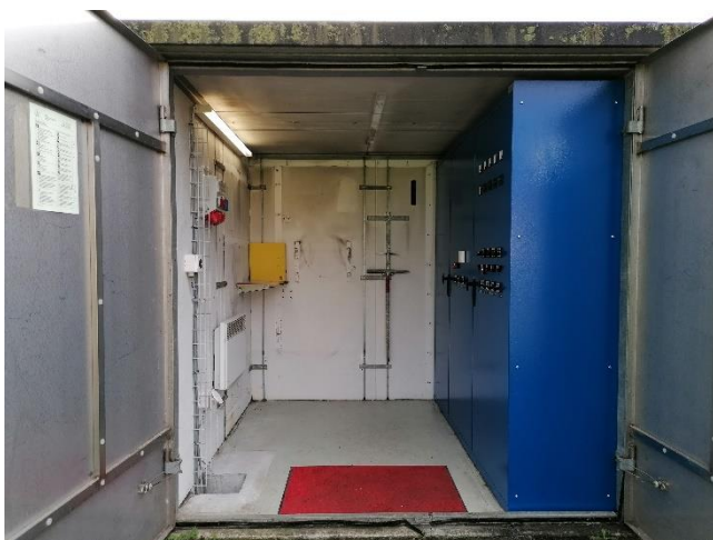
Pumpwerk Erlen, Ersatz EMSRL inkl. Schaltschrank
