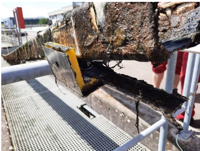
Gerissener Räumerbalken im Nachklärbecken
