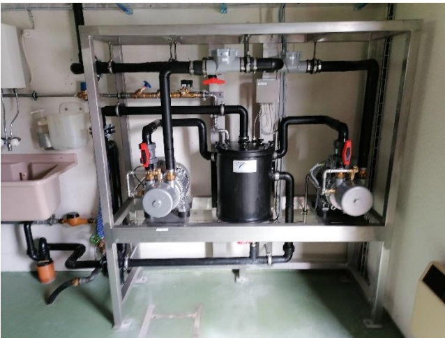
Ersatz der alten Pumpe durch zwei redundante Vakuumpumpen mit Armaturen in Modulbauweise
