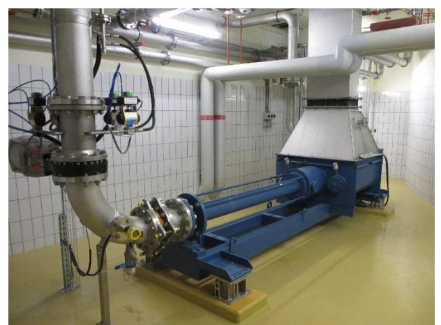
Beschickungspumpe zu Silo
