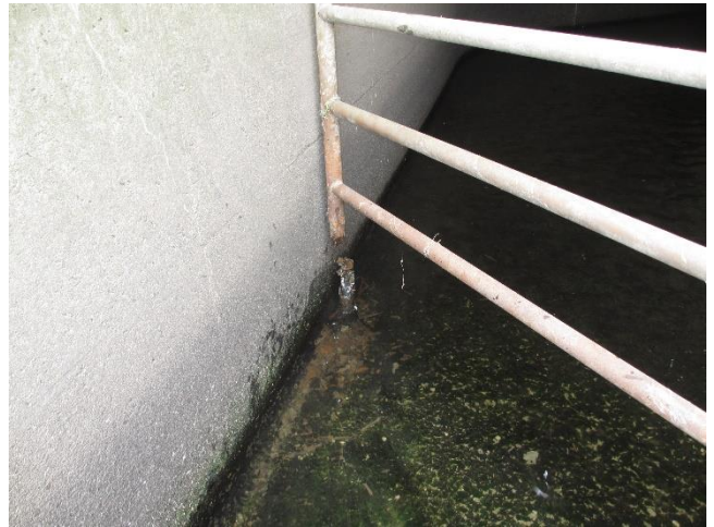
Durchgerostetes Gitter ARA Abfluss reparieren
