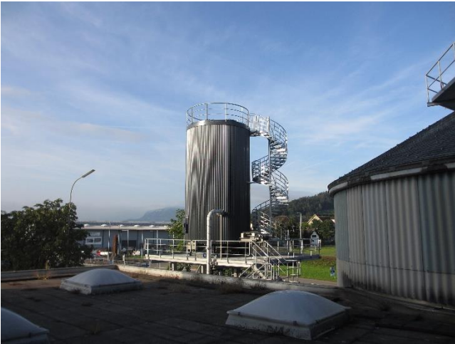
Silo für entwässerten Faulschlamm
